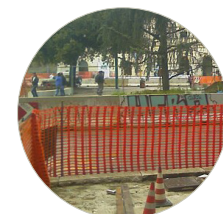
Esempio di utilizzo della recinzione cantiere
